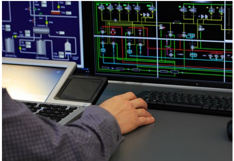
Elektrodistribucijska podjetja so glavna tarča zaradi strateškega pomena in zastarele tehnologije nadzora.
