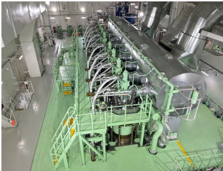
Pogled v strojnico Maerskove ladje, ki uporablja zeleni metanol. (Foto: Maersk)
