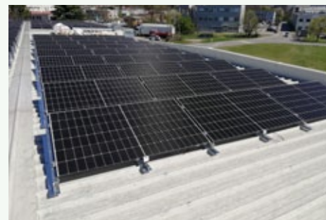
Na strehah delavnic na Goriškem in Koroškem smo postavili dve sončni elektrarni, ki zagotavljata del energije za njuno delovanje.
