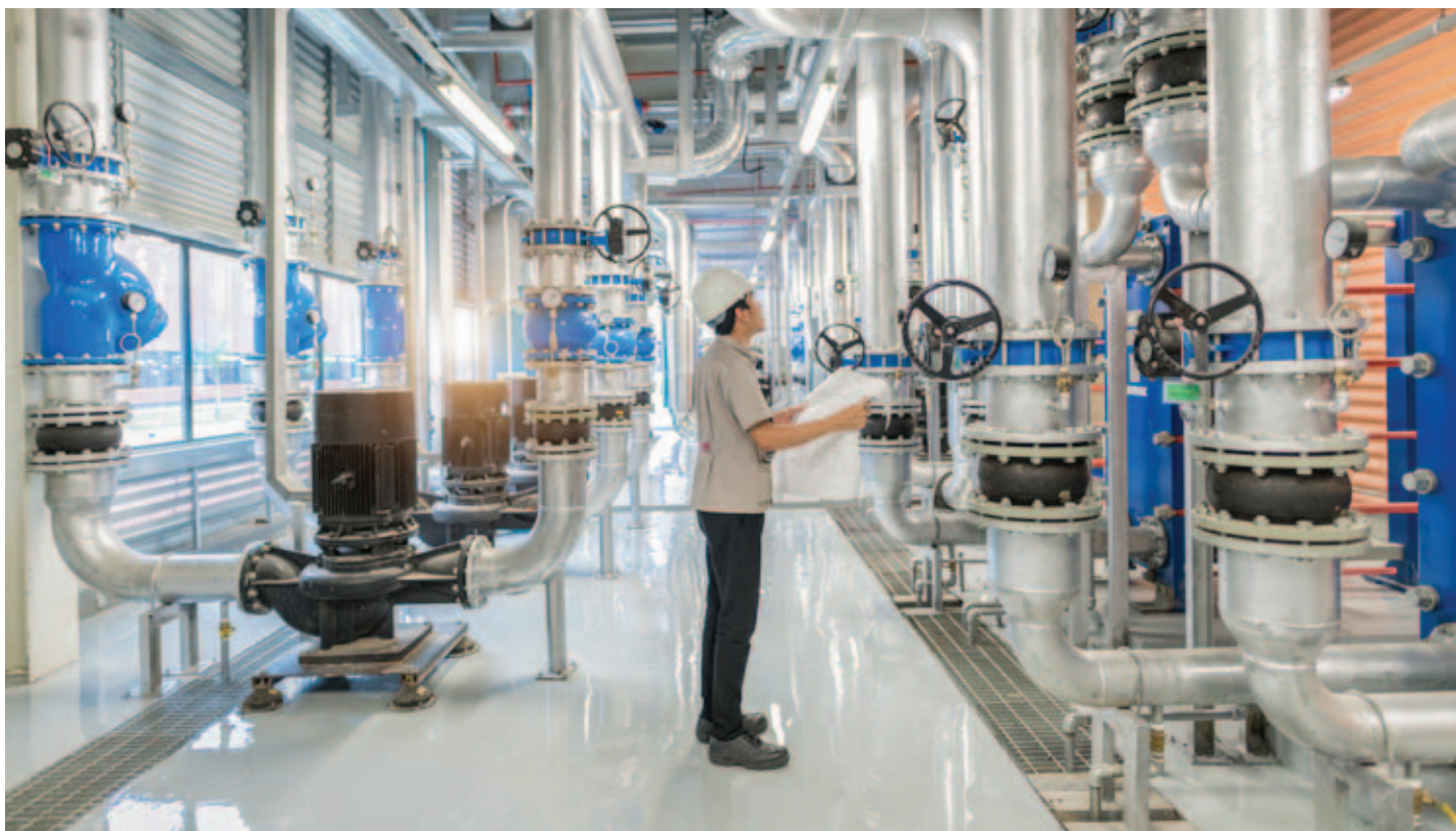
Največkrat industrija zahteva ultra čisto vodo, ki se pripravlja po postopku reverzne osmoze.
