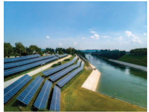
Sončna elektrarna Zlatoličje na infrastrukturi hidroelektrarne
