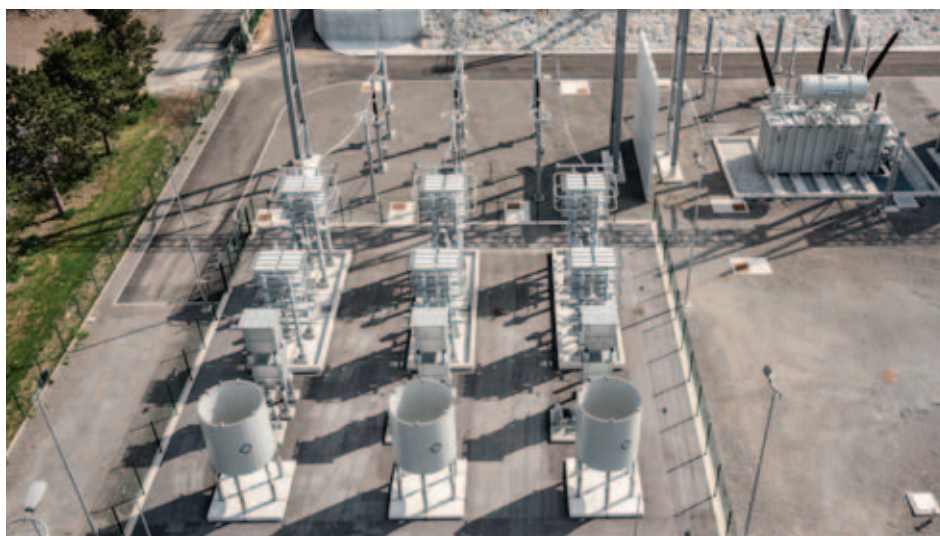
Regulacijska dušilka in energetski transformator v RTP Divača.
