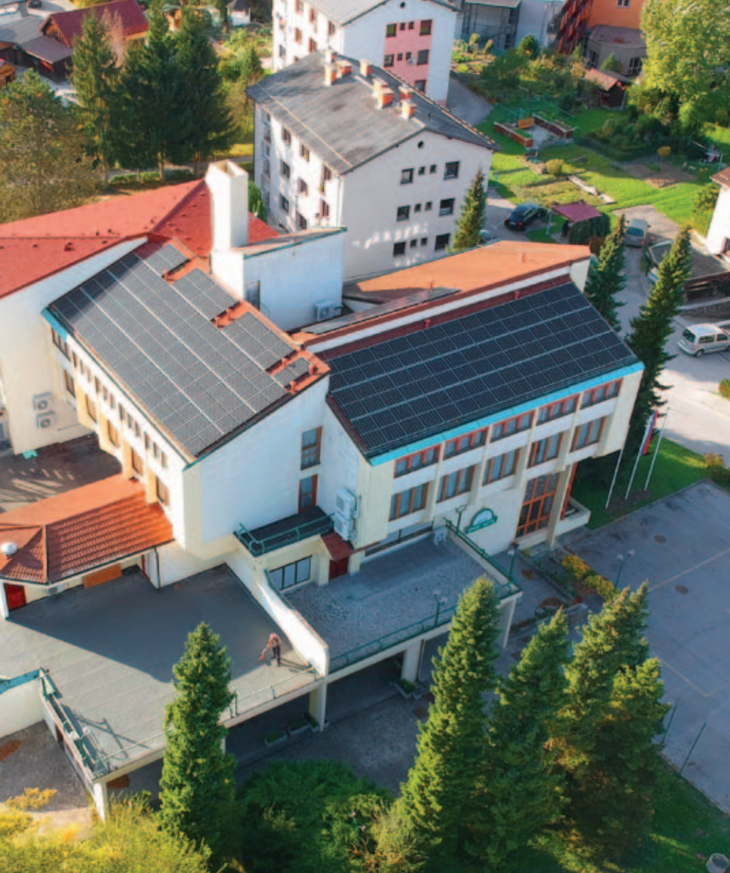
V Hotelu Prebold je Termo Shop vzpostavil celovit energetski sistem.
