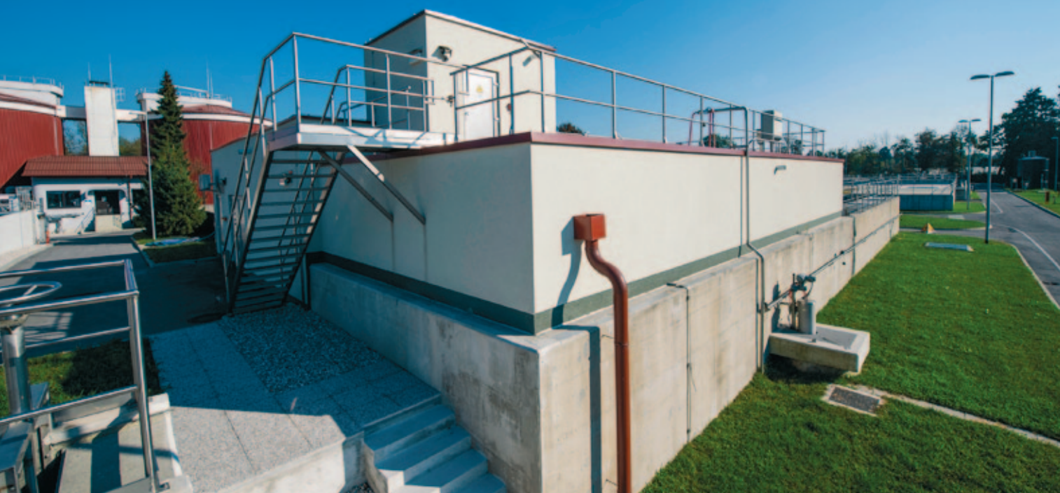
CČN Domžale – Kamnik: centrifugat iz strojnega zgoščanja se vodi v deamonifikacijski bazen, ki deluje v sekvenčnem režimu. (foto: Klemen Razingner)
