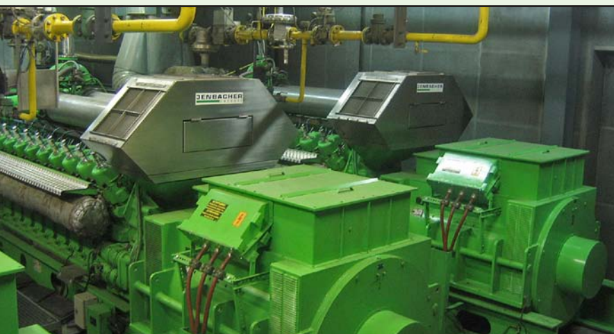
Kogeneracijski postroj v Petrolu Energetiki d.o.o. na Ravnah na koroškem, ki ga bomo obnovili.
