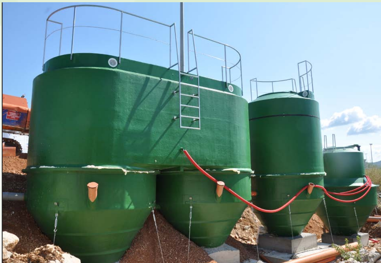
Z malimi biološkimi čistilnimi napravami (na fotografiji v procesu gradnje) smo do konca leta 2012 opremili 69 bencinskih servisov, kjer lokalni kanalizacijski sistemi ne omogočajo ustreznega odvajanja in čiščenja komunalnih odpadnih voda.
