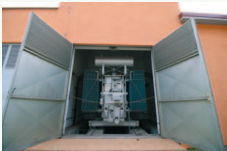
Distribucijski transformator v transformatorski postaji.
