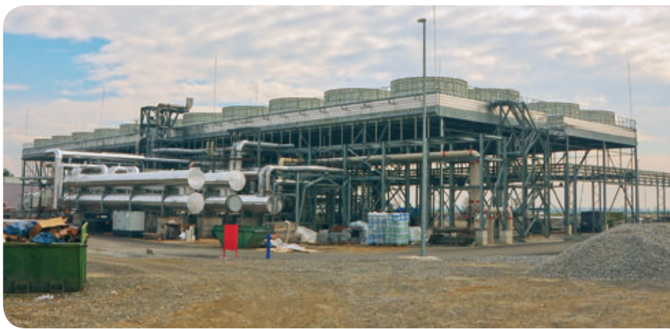
Binarna geotermalna elektrarna v Veliki Cigleni (Hrvaška). Foto: Luka Serianz
