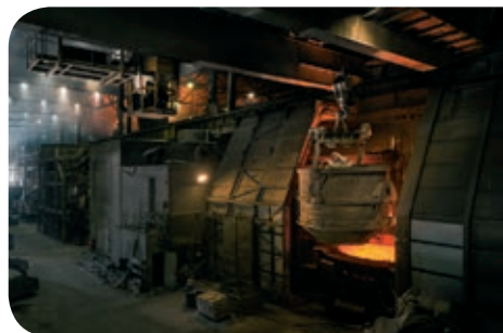
Elektroobločna peč v podjetju SIJ Metal Ravne, ki je vir tople vode za ogrevanje gospodarskega območja in mesta Ravne
