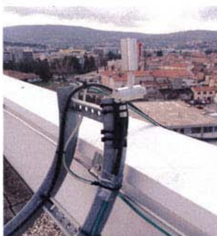
Slika 17. Naprava za spremljanje črnega ogljika v zraku, postavljena znotraj pristanišča
